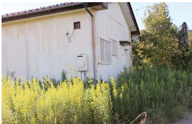
雑草が繁茂する空家住宅
