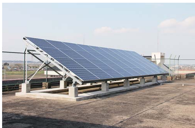
東中に設置されている太陽光発電設備
