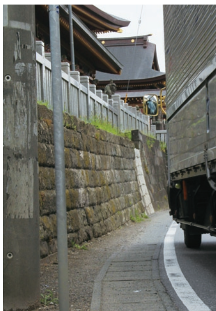
危険!! 早急な安全確保が望まれる 阿波小学校通学路 (125号線沿い)
