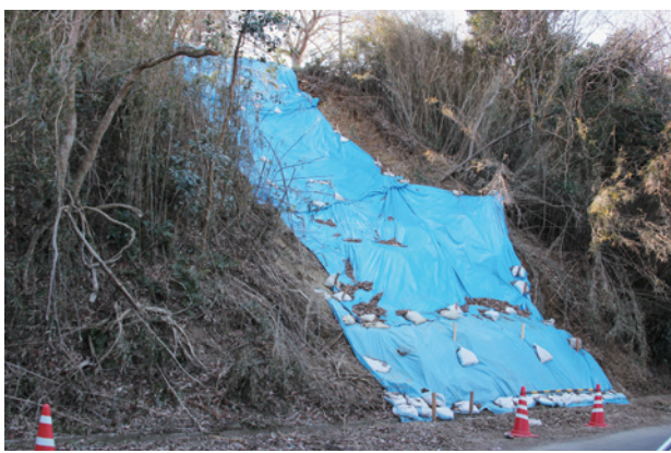
台風26号によるがけ崩れ被害（駒塚地区）
