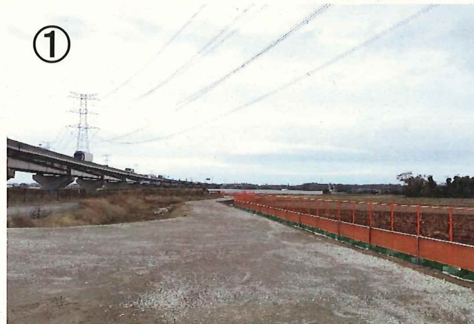
① 工事用車両が通行する道路が完成しました。ご協力ありがとうございました。道路延長は約1kmです。
