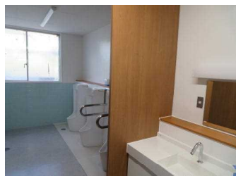
新しいトイレの様子
