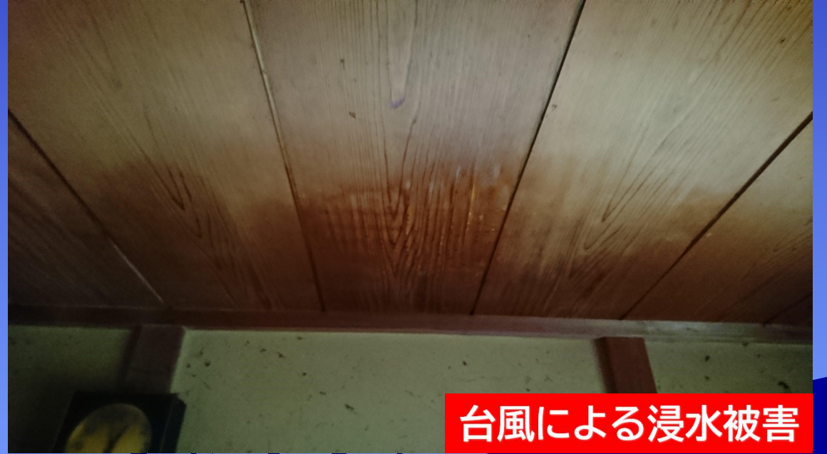
台風による建物被害
