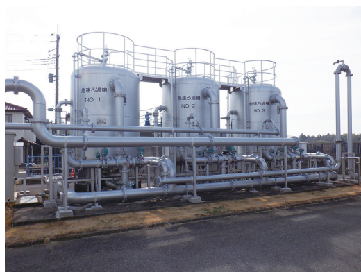
江戸崎浄水場 急速ろ過機
