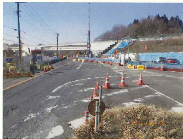
下部工工事を行う施工ヤードとして 現在市道3216号線の切り回しを行っ ております。
