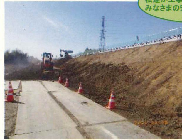
土工工事では、工事現場の土砂の掘削 や運搬、盛土を行っております。引 続き土砂を使用する土工を進めてま います。
