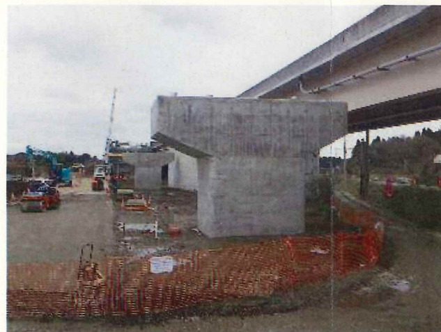
下部工工事では、橋脚の構築が一部 完了しております。引き続き残る下 部工の「底版、柱、梁」の構築を進 めてまいります。
