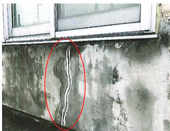
外回り：各壁面の劣化
