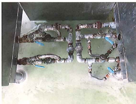
各諸室：全体的な蒸気配管類の劣化
