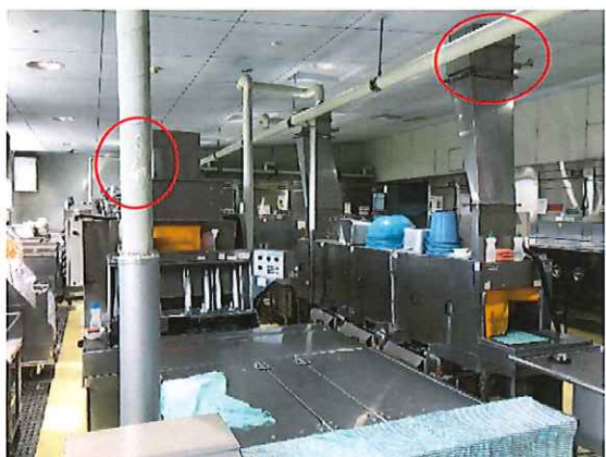
洗浄室：天井配管類及びダクトの劣化
