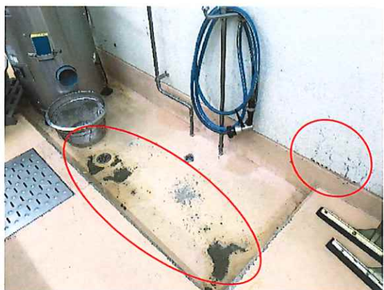
下処理室：室内壁面及び床面の劣化
