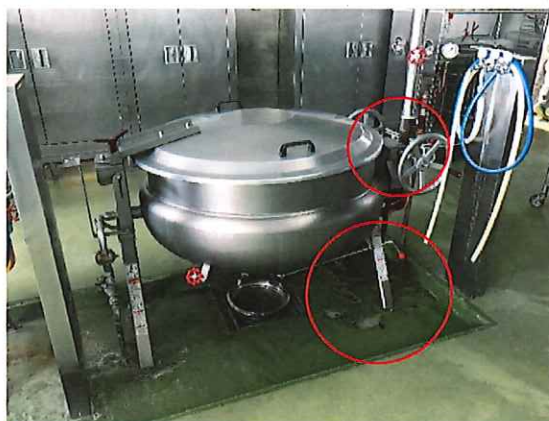
調理室：厨房機器及び床面の劣化
