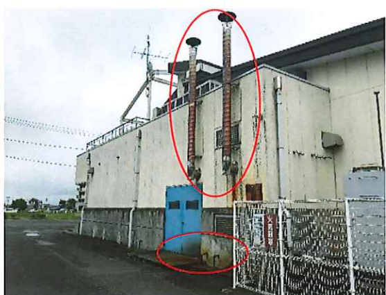
外回り：ボイラー排気塔及び壁面の劣化
