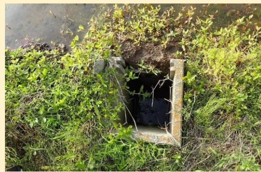
水田給水栓付近での繁茂
