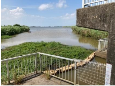
①侵入防止フェンス
